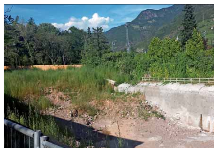
Die Arbeiten auf der Baustelle bei den Ex-Tennisplätzen können wieder aufgenommen werden. pir
